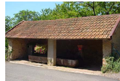
Lavoir avant travaux (toiture en mauvais état, murs dégradés)
