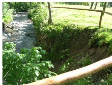
Erosion à l'étang de la digue à Moussey
